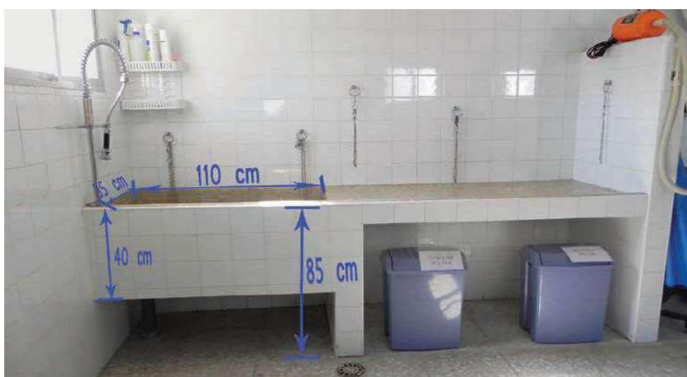
Sala de baños correctamente dotada
