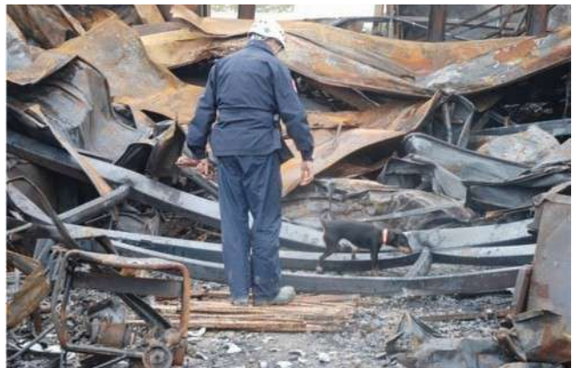
Búsqueda en incendio de edificio
