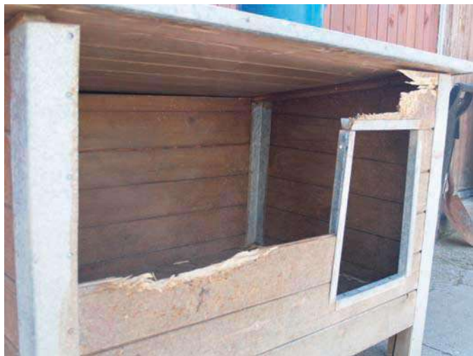
Caseta mordida por «pica»
